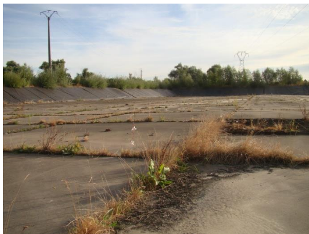
Figure 35 : Une flore exogène spontanée se développe dans les joints du fond du bassin – Septembre 2016 – B. DEROLEZ
